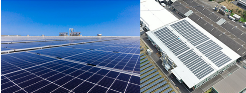
新工場棟に設置した太陽光発電設備 住友林業クレスト鹿島工場新工場棟
