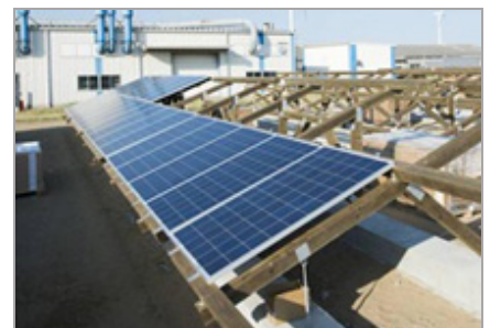
太陽光パネルと 環境にも配慮した木製架台
