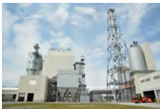
紋別バイオマス発電所
