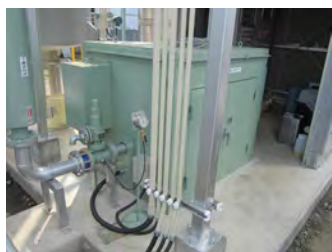
生物処理設備（曝気ブロー）
