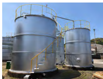
生物処理設備（曝気槽）
