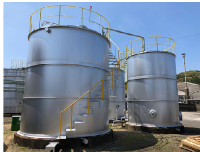
生物処理設備（曝気槽）
