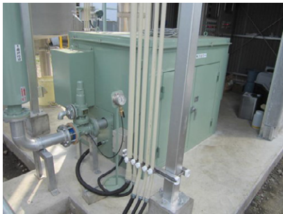
生物処理設備（曝気ブローワー）
